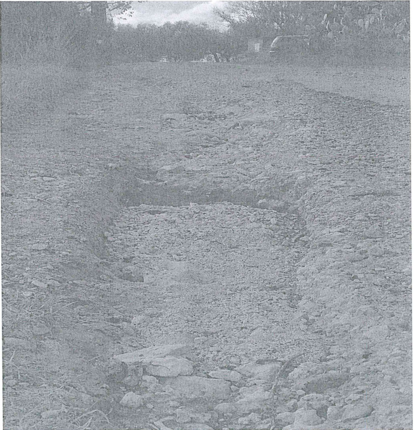
Erosione e dissesto Strada vicinale Ferleta – Tuscania (Vt)
