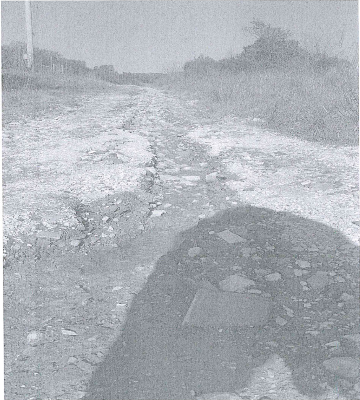
Erosione strada bianca "Solagne"
