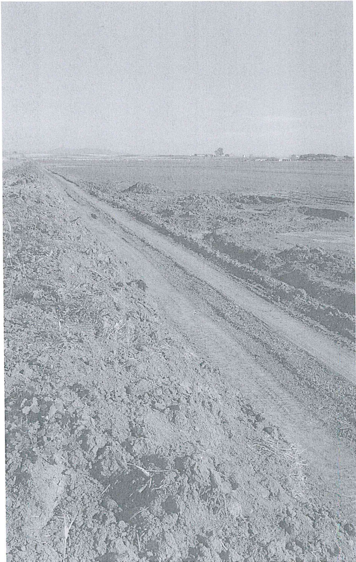
Argini di bonifica Canale Margherita (Montalto di Castro) ripristinati dopo la piena con terreno agricolo..
