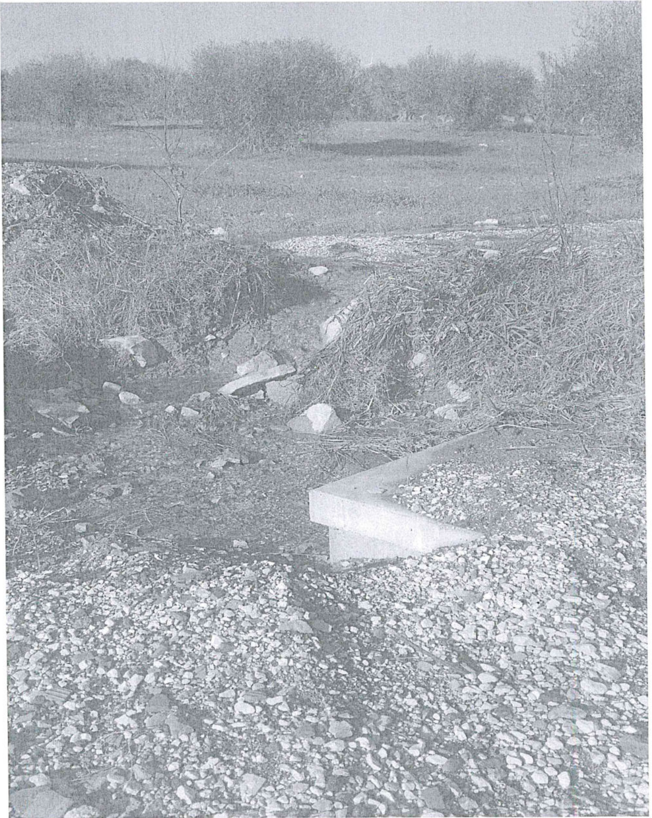
Erosione e deposito materiale inerte su diramazione strada Poggio Barone.
